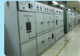
ห้องควบคุมไฟฟ้า Electric Cabin
